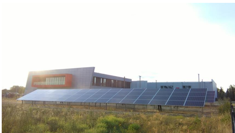
Fot. Elektrownia fotowoltaiczna o mocy 40 kWp przy hurtowni – woj. Łódzkie. (archiwum własne autorów).
