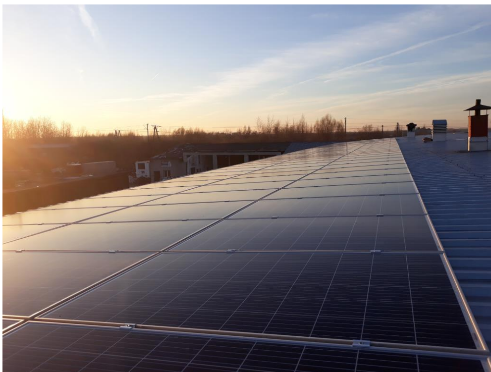
Ryc. Elektrownia fotowoltaiczna o mocy 33 kWp na halach magazynowych. (archiwum własne autorów).
